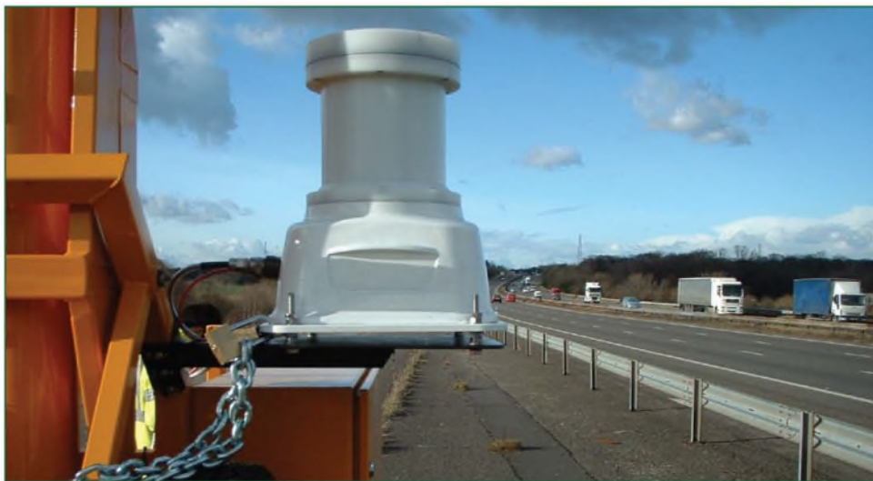
Esempi di apparecchiature rilevamento incidenti
