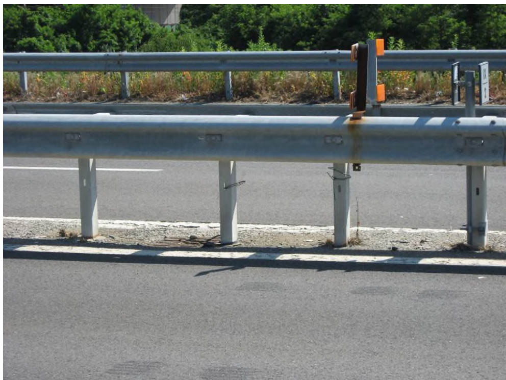
Barriera spartitraffico esistente in corrispondenza di caditoia (tratti in curva)
