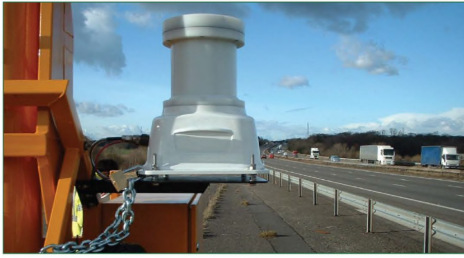
Esempi di apparecchiature rilevamento incidenti
